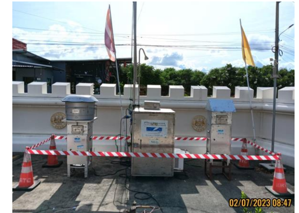
การติดตั้งเครื่องตรวจคุณภาพอากาศ ระดับเสียง และความสั่นสะเทือน บริเวณวัดของพลู
